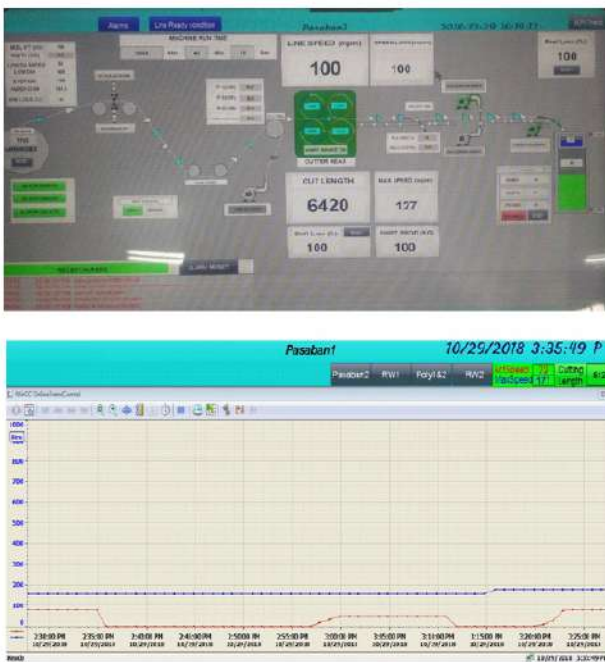
Online tracking of machine critical parameter
