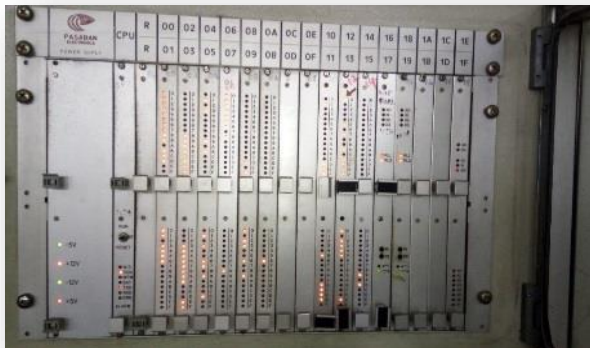
Pasaban PLC (Before)
